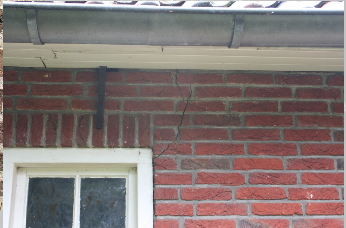
Scheuren in gevel met keihard voegwerk
