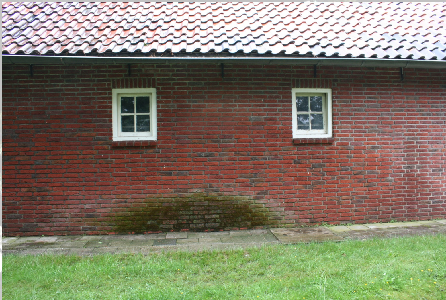
Achterstallig onderhoud, goot verstopt en buigt door
