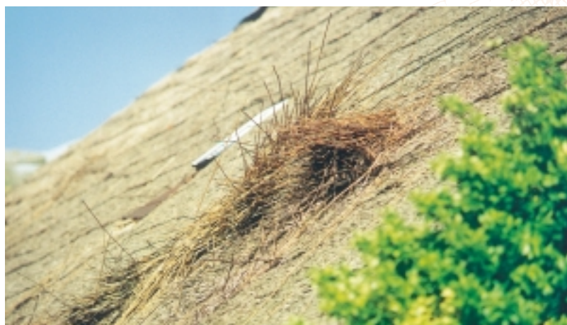
Stormschade. De gaarden zijn in het zicht gekomen. Het is tijd voor het nemen van maatregelen, omdat bij verdere slijtage het riet los komt te liggen
