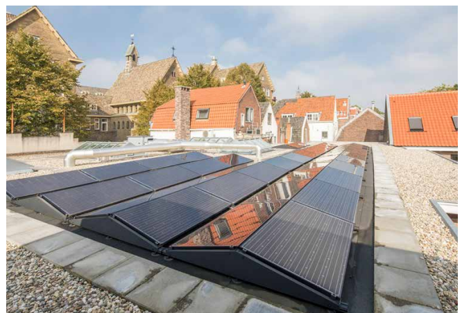
Oost-west-opstelling van zonnepanelen op een plat dak
