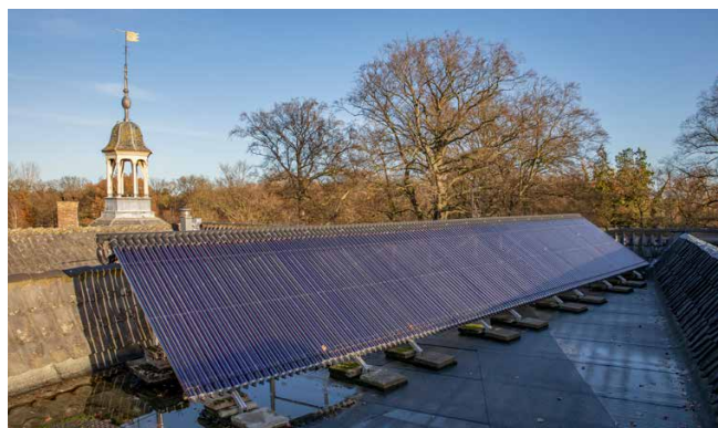
Vacuümbuiscollectoren voor warmtewinning
