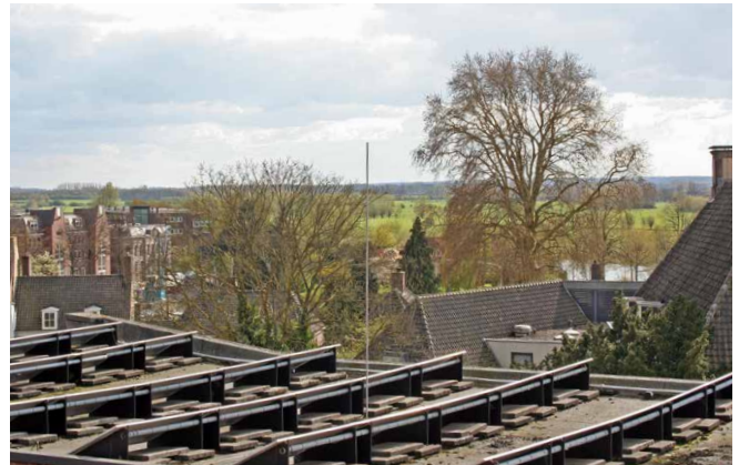
Bliksemafleider om zonnepanelen te beschermen tegen inslag
