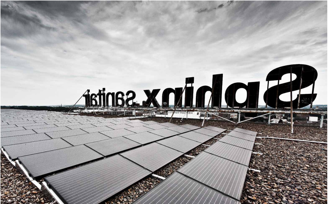
Zonnepanelen voor stroomopwekking
