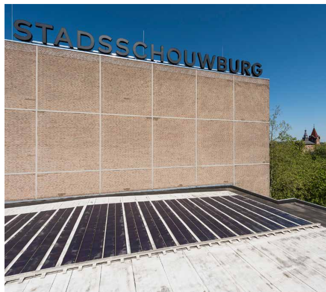
Pv-folie voor stroomopwekking op een plat dak
